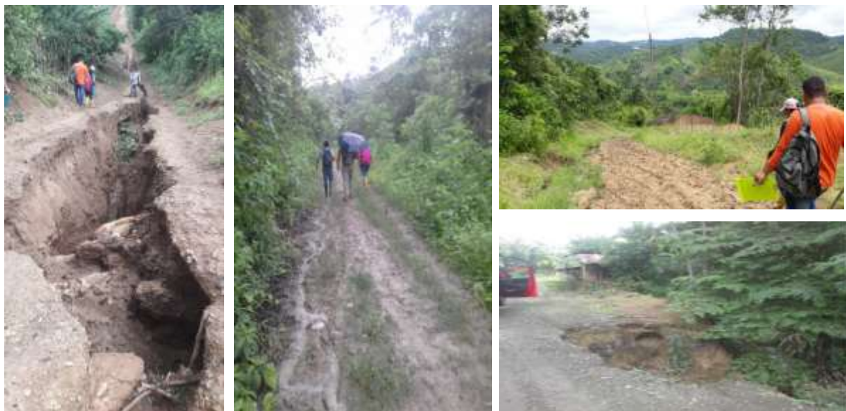
Ilustración 3 Vías en mal estado
